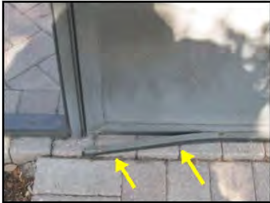
Bottom door seal loose on side Screen Door
